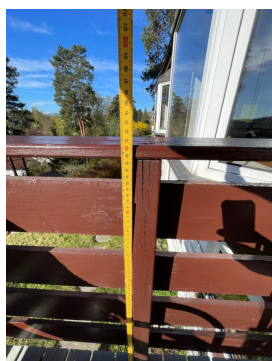
Rekkverk balkong under 100 cm
