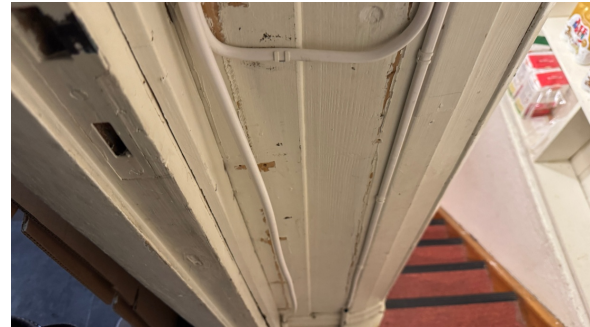
Kabler er ikke tilfredsstillende festet (TG3).
