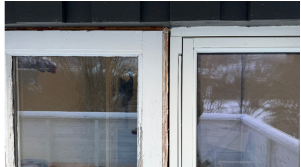
Det er påvist avvik rundt innsettsdetaljer.
