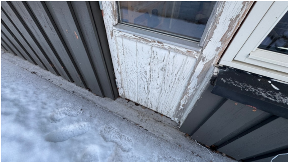
Terrassedøren er værslitt.
