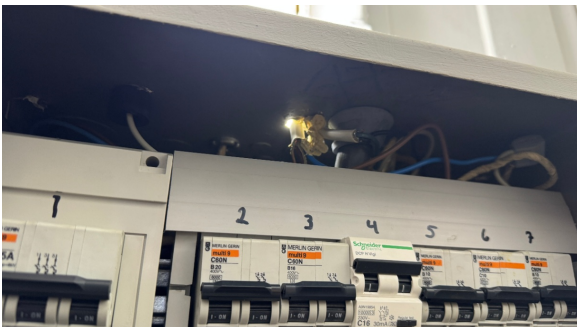
Kabelinnføringer i sikringskap er ikke tilfredsstillende tettet. (TG3)
