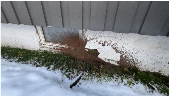
Grunnmuren har sprekkdannelser.
