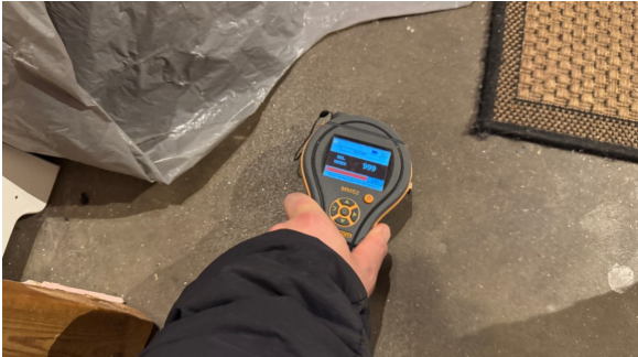
Det er påvist indikasjoner på noe fuktgjennomtrenging i kjellergulv.
