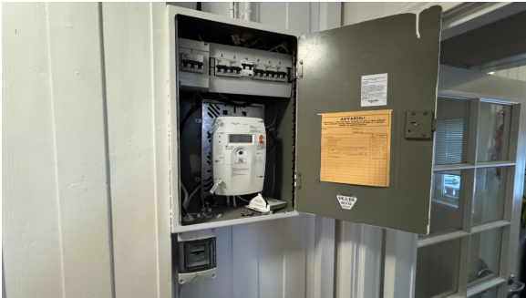
Kontroll av el-skap og kursfortegnelse.
