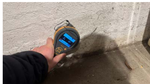
Det er påvist indikasjoner på noe fuktgjennomtrenging inn i kjellermur.
