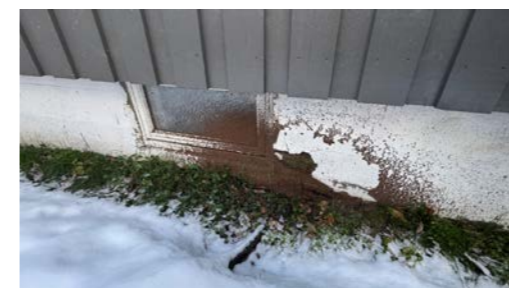
Grunnmuren har sprekkdannelser.
