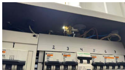
Kabelinnføringer i sikringskap er ikke tilfredsstillende tett. (TG3)
