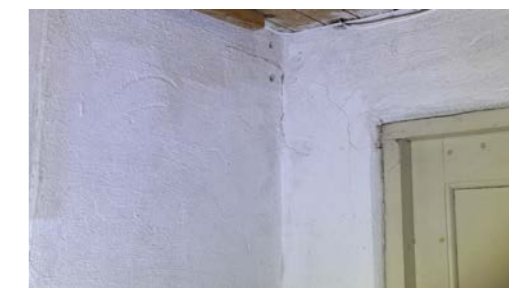
Grunnmuren har sprekkdannelser.
