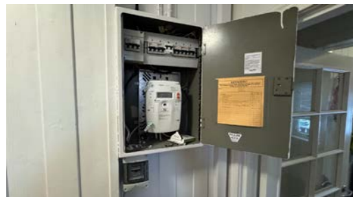
Kontroll av el-skap og kursfortegnelse.
