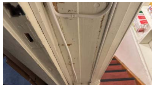
Kabler er ikke tilfredsstillende festet (TG3).
