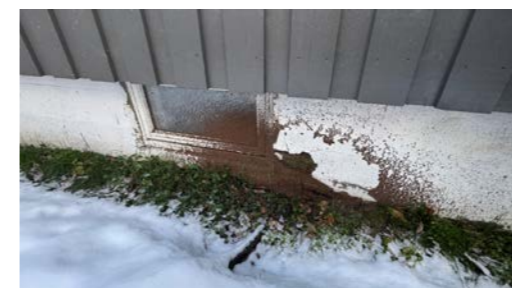
Grunnmuren har sprekkdannelser.
