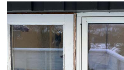
Det er påvist avvik rundt innsettsdetaljer.
