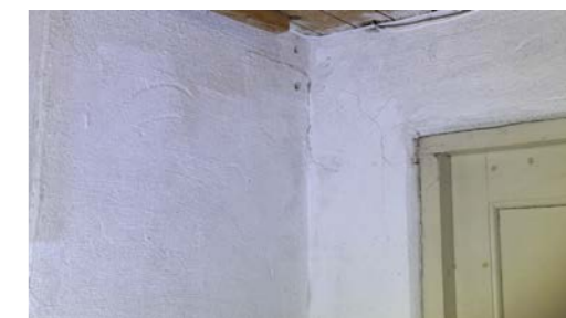
Grunnmuren har sprekkdannelser.
