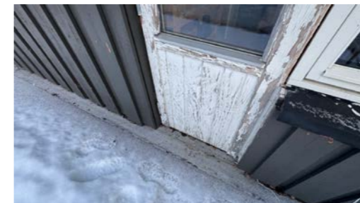
Terrassedøren er værslitt.
