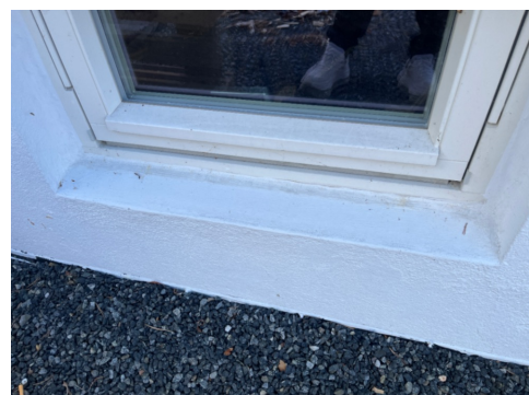
Manglende beslag mot kjellervindu.
