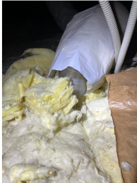
Manglende isolering mot ventilasjonsrør fra bad 1.etg.
