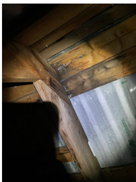
Fuktmerker på takkonstruksjonen
