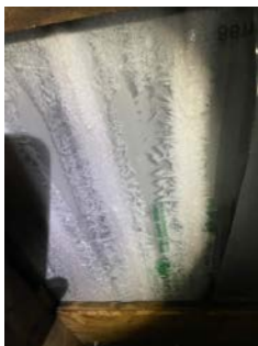
Kondensering og frostdannelse på undertak
