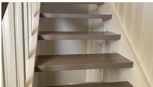
Foto viser innvendig trapp med åpninger mellom trinnene på ca 135 mm. Foto viser også manglende håndlist
