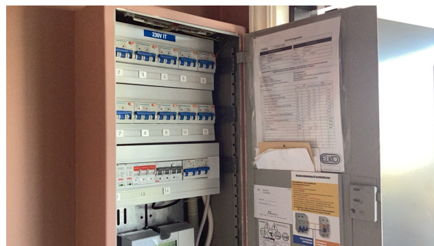
Oversiktsfoto av sikrings-skapet i etreen.
