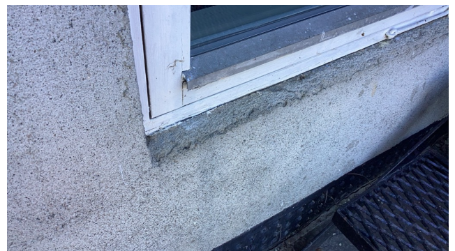
Foto viser lite gunstig innpussing av kjellervindu.
