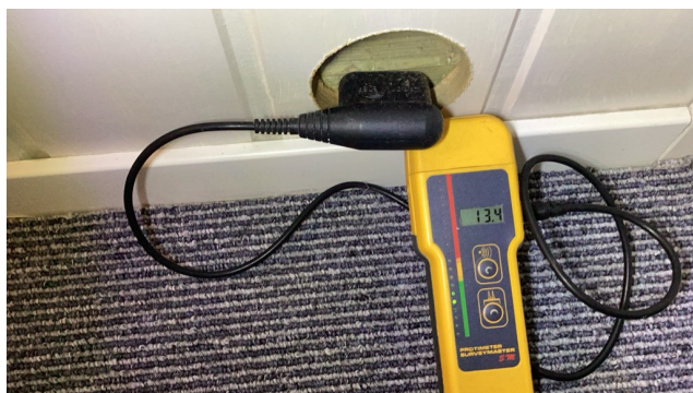
Foto viser måling med fuktindikator ved innstikk i nedre spikerslag/bunnsvillen i veggen og som viste ca 13-14 % fukt-kvote.
