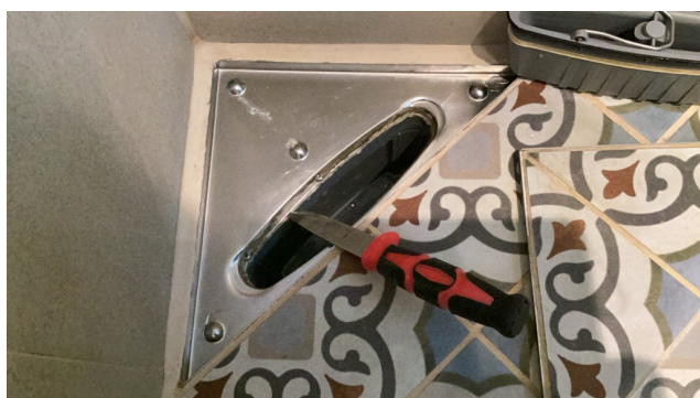
Foto viser knivspiss som peker på membran/slukmansjett ved klemringen i sluket.
