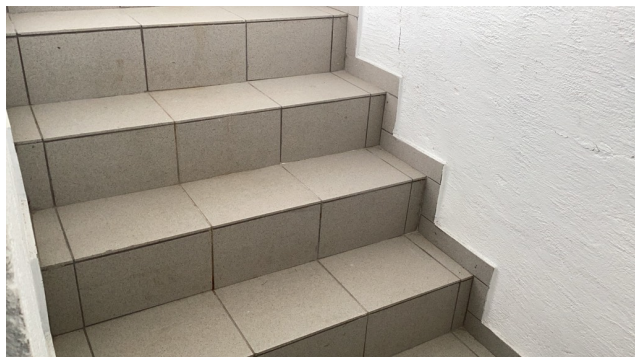
Foto av trapp i forbindelse med utvendig adkomst til kjelleren hvor det ikke er montert håndlister
