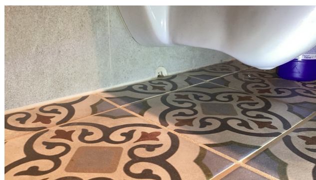
Foto viser at det er montert drenshull under toalettet for å synliggjøre evt. vannlekkasje i innebygget sistene.
