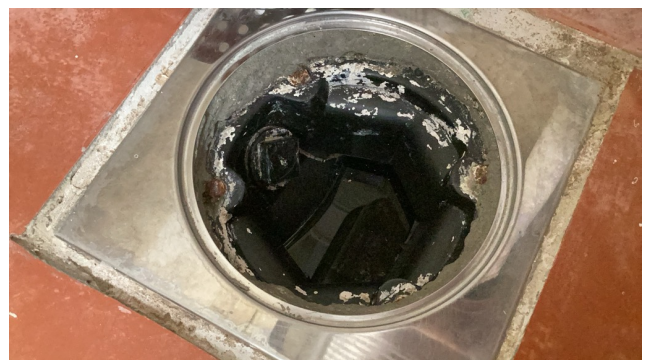
Foto viser ingen synlig membran i sluket
