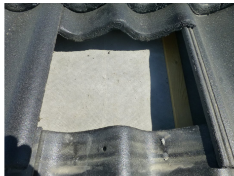
Foto viser forholdene under taktekket.
