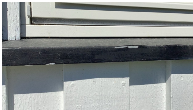
Foto viser vannbrettbeslag med avflakkinger
