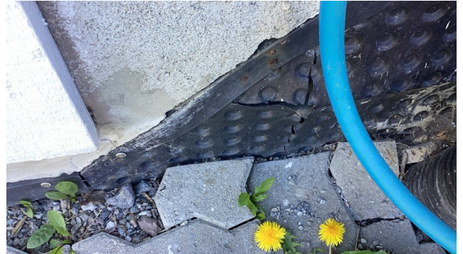
Foto viser eksempel på skader i knotteplasten.
