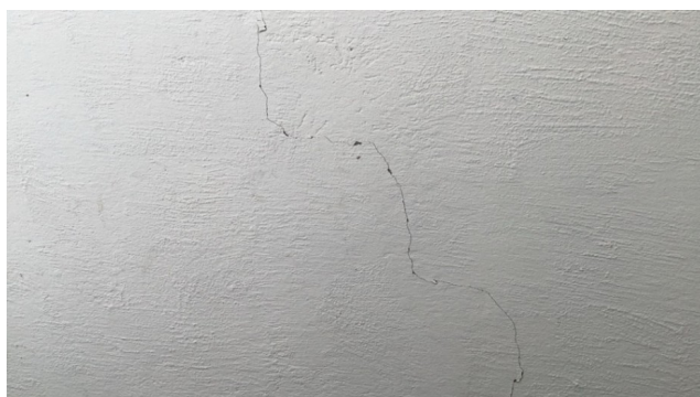
Foto viser sprekkdannelse i vegg ved utvendig adkomst til kjelleren.
