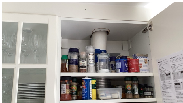
Foto viser at ventilatoren er koblet til avtrekkskanal i plast materiale.
