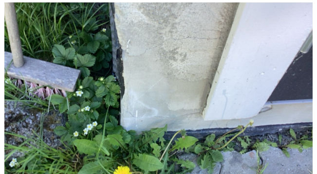
Foto viser mindre rissprekker, som er synlige fra utvendig side.
