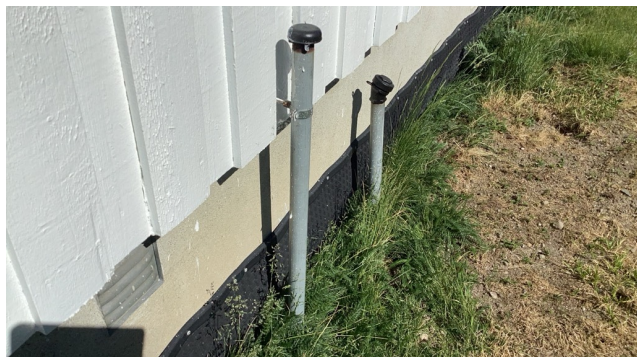
Foto viser påfyllingsrør og lufterør tilhørende tanken.
