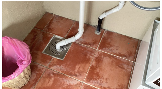
Foto viser ingen mansjetter på røroppstikk i gulvet
