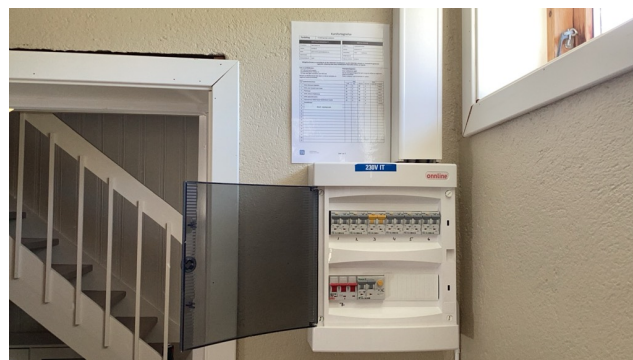
Oversiktsfoto av fordelerskapet i vaskerommet.
