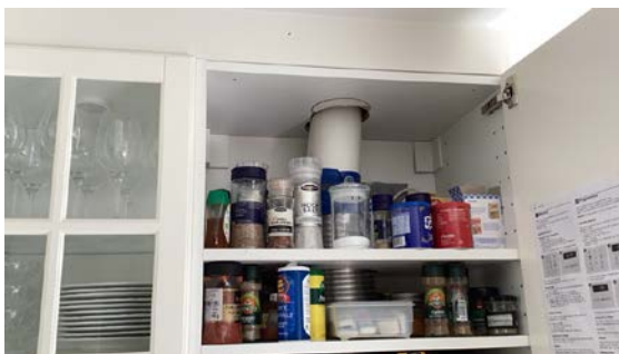
Foto viser at ventilatoren er koblet til avtrekkskanal i plast materiale.
