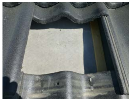
Foto viser forholdene under taktekket.
