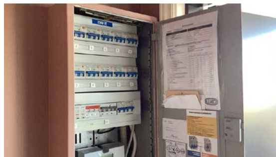
Oversiktsfoto av sikrings-skapet i entreen.
