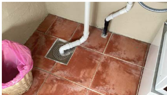
Foto viser ingen mansjetter på røroppstikk i gulvet
