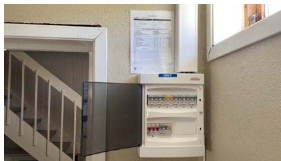
Oversiktsfoto av fordelerskapet i vaskerommet.
