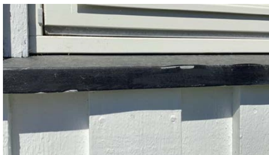
Foto viser vannbrettbeslag med avflakkinger
