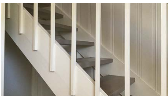
Foto viser innvendig trapp med åpninger mellom spilene på rekkverket på ca 135 mm.
