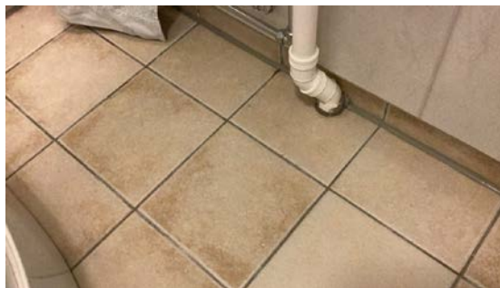
Foto viser ingen rørmansjetter på røroppstikk i gulvet
