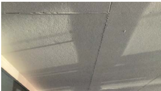
Foto viser avvik i skjøtene på himlingsplatene i stue/allrom. Platene har "heng" noe som ikke fremkommer på foto.
