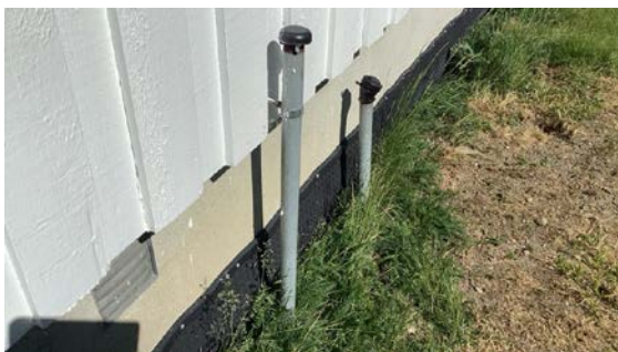
Foto viser påfyllingsrør og lufferør tilhørende tanken.
