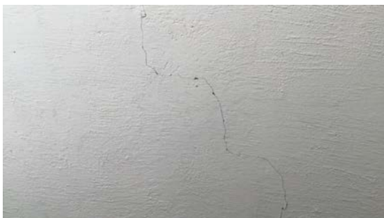
Foto viser sprekkdannelser i vegg ved utvendig adkomst til kjelleren.
