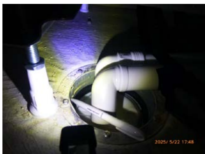
Foto viser kulepenn som peker på synlig membran ved klemringen i sluket under badekaret
