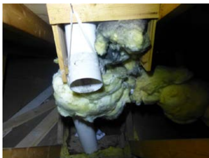
Foto er fra loftet og viser "åpen" ventilasjonskanal i plast materiale.
