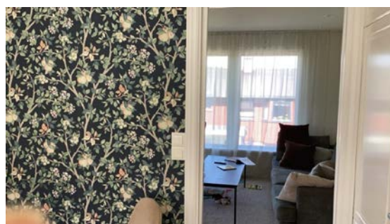
Foto viser skjevheter vedr. skyvedøren til kjøkkenet.
