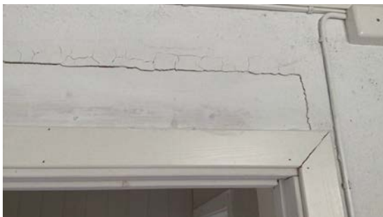
Foto viser eksempel på sprekk igjenkledd område over dør.
