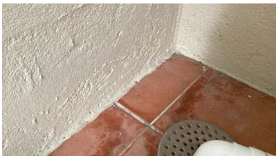
Foto viser ingen membran eller annen type vanntett overgang mellom gulv og vegg
