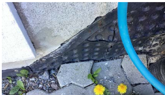
Foto viser eksempel på skader i knotteplasten.
