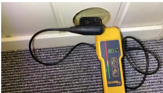
Foto viser måling med fuktindikator ved innstikk i nedre spikerslag/bunnsvillen i veggen og som viste ca 13-14 % fukt-kvot.
