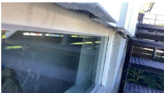
Foto viser nedkant av stående utvendig trepanel som ikke er skråskåret
