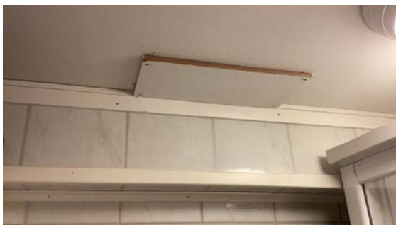
Foto viser plate i himlingen som er skrudd til underlaget og ble ikke demontert ved befaring. Årsaken til monteringen er ikke kjent.
