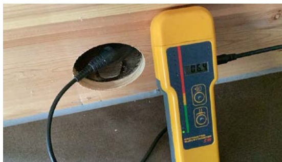
Foto viser fuktmåling ved innstikk av elektrodene i bunnsvillen i vegg. Målingene viste ikke forhøyet fuktighet, ca 6-7 % fukt-kvote.
