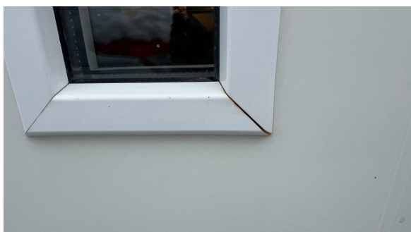
Skader på ytterdøren til leilighet C
