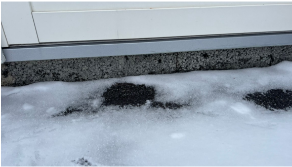
Grunnmuren under balkongdør.
