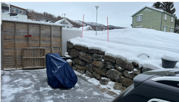
Støttemurer utenfor leilighetene mangler rekkverk.
