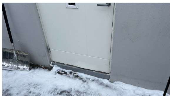
Skader på ytterdøren til leilighet C
