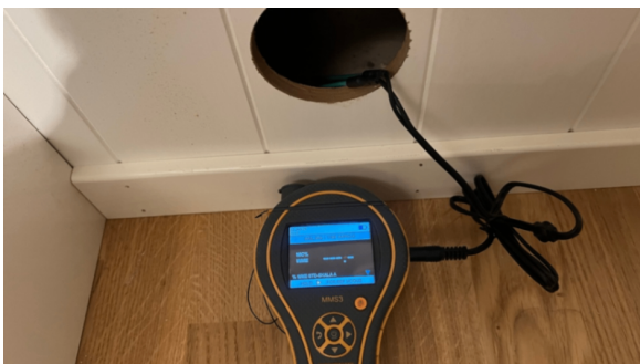
Fuktmålin mot badet på veggen mellom toalettet og dusjkabinettet
