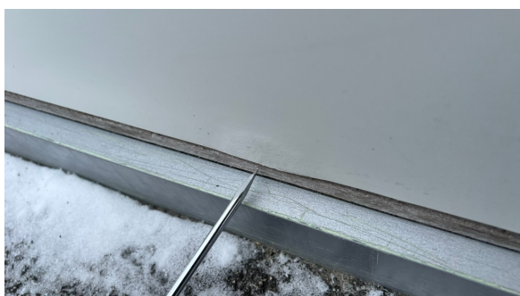
Skader på ytterdøren til leilighet B
