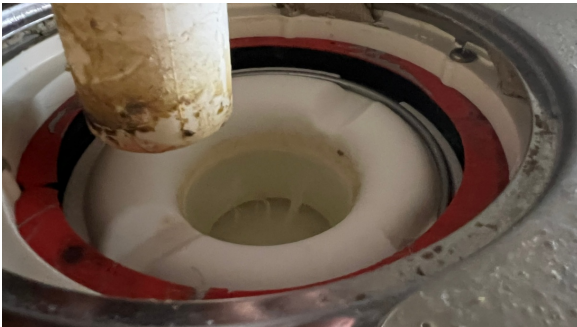
Sluk under dusjkabinettet
