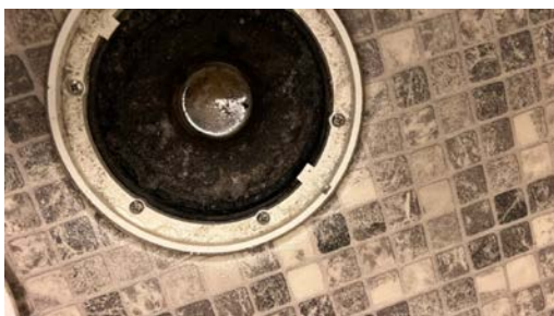
Sluk på vaskerommet
