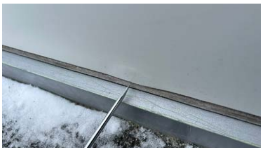
Skader på ytterdøren til leilighet B
