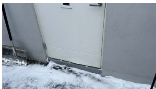
Skader på ytterdøren til leilighet C
