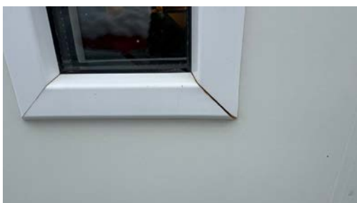
Skader på ytterdøren til leilighet C
