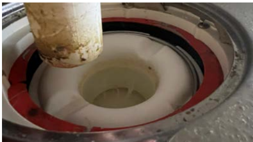
Sluk under dusjkabinettet
