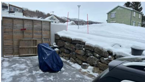
Støttemurer utenfor leilighetene mangler rekkverk.
