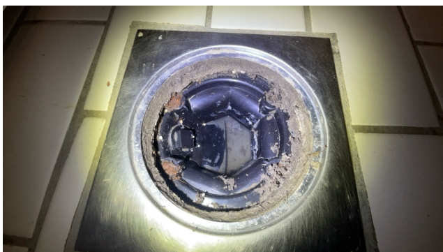
Sluk- ikke synlig membran
