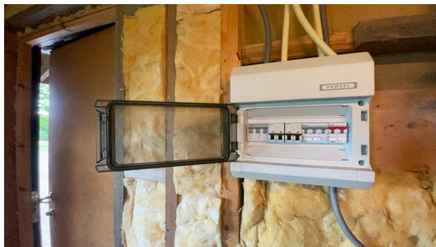
Umerket skap i garasje
