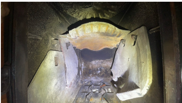
Skadede brannplater i ovn
