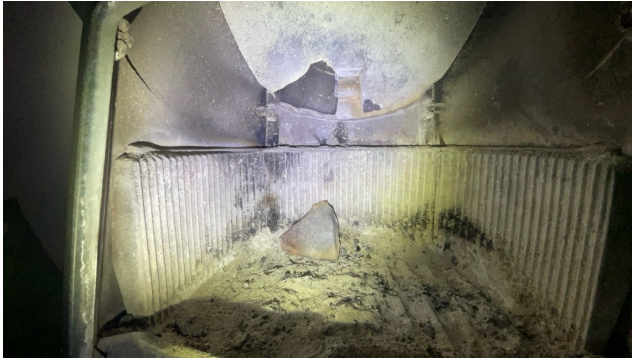
Skadet hvelv ovn
