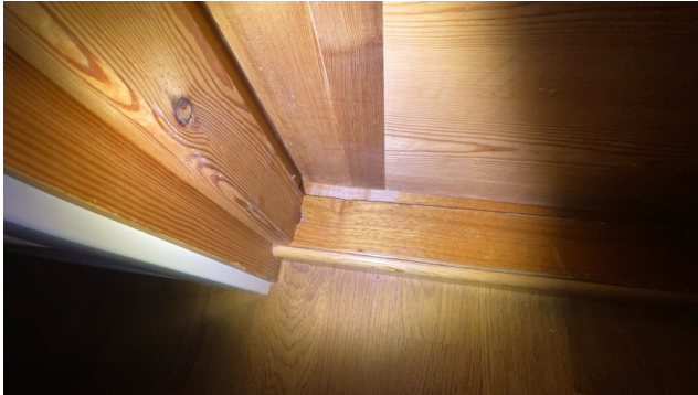
Dør som tar i terskel
