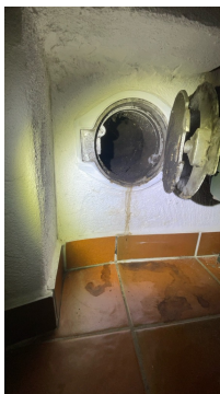
Rennemerke etter fukt ned pipe under sotluke
