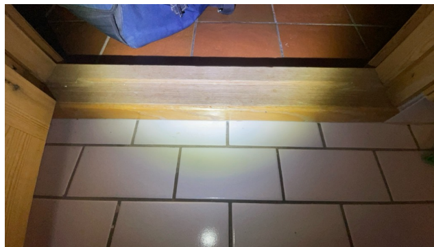
Ikke synlig membran ved terskel
