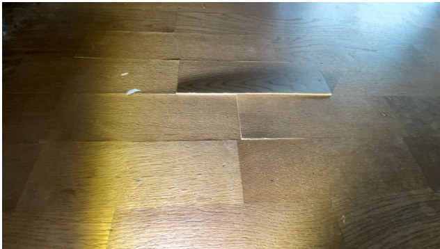
Eksempel oppsprekk/oppkuving i parkett
