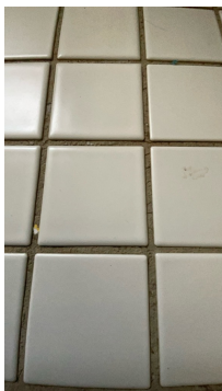
Litt småsprekker/forvitring i fuger
