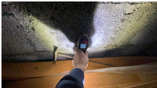
Forhøyninger enkelte steder ved fuktsøk på muroverflater
