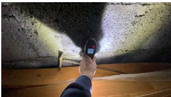
Forhøyninger enkelte steder ved fuktsøk på muroverflater
