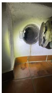
Rennemerke etter fukt ned pipe under sotluke
