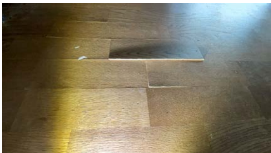
Eksempel oppsprekk/oppkuving i parkett
