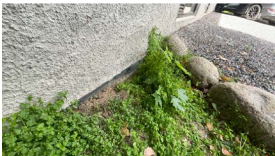
Observert fuktsperre, men kan ikke verifiseres rundt hele
