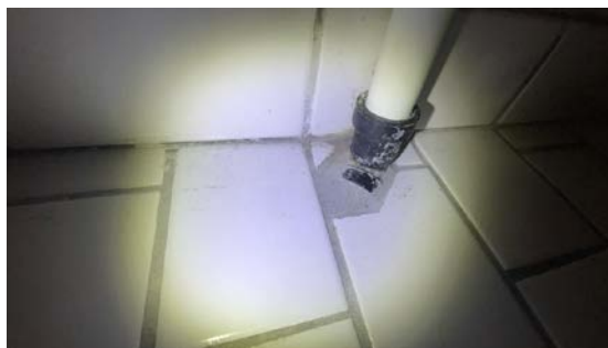
Ikke synlig membran ved røroppstikk
