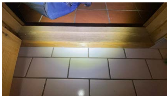
Ikke synlig membran ved terskel
