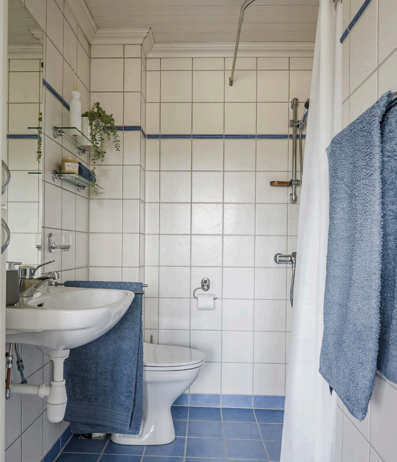
Baderom 2 ble pusset opp av firma i 1999. Baderommet har blå fliser på gulv med gulvvarme, lyse fliser på veggene og downlights i himlingen. Baderommet er utstyrt med vegghengt servant med speil over, dusjhjørne med forheng og gulvstående toalett.
