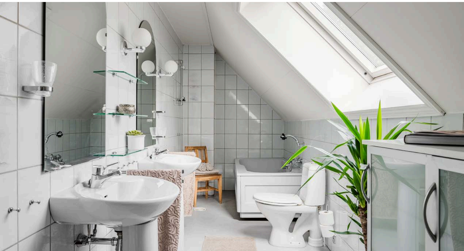
Baderom 1 er et stort, lyst og pent baderom fra byggeåret. Grunnet alder anbefaler takstmann at baderommet totalrenoveres.
