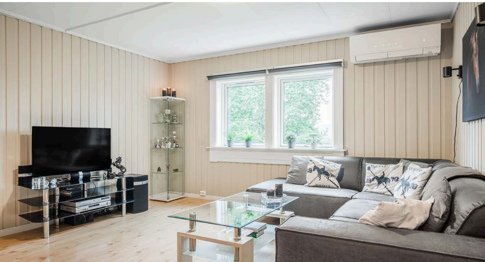
Montert luft-til-luft varmepumpe som sørger for en god og jevn varme.
