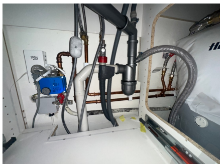
Røropplegg i kjøkkenbenk med Waterguard
