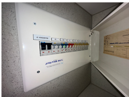
Sikringsskap med automatsikringer.
