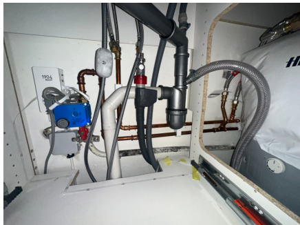
Røropplegg i kjøkkenbenk med Waterguard
