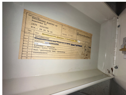
Kursoversikt i sikringsskap
