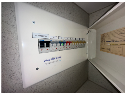
Sikringsskap med automatsikringer.
