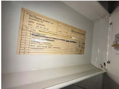
Kursoversikt i sikringsskap
