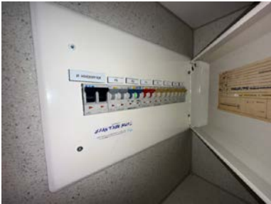
Sikringsskap med automatsikringer.
