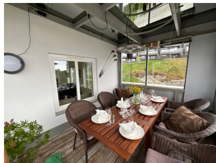
Drypper litt fra taket.
