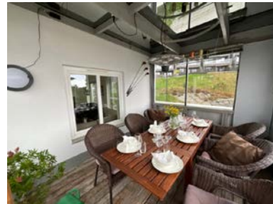
Drypper litt fra taket.
