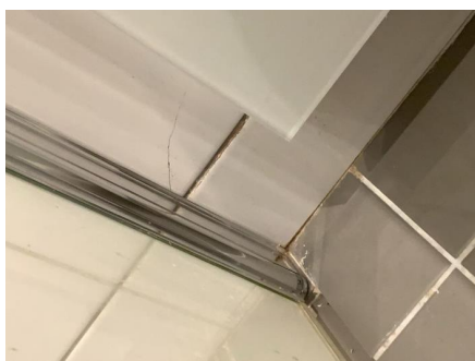
Sprekk i flis mellom toalett og dusjvegg.
