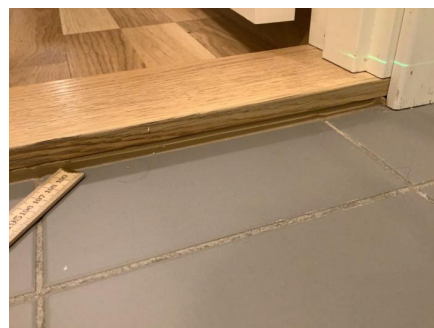
Det er oppkant ved terskel i dør.
