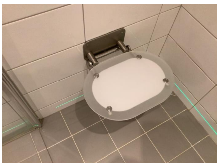
Det er montert dusjstol i dusjsonen.
