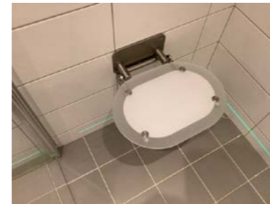
Det er montert dusjstol i dusjsonen.
