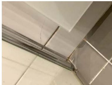
Sprekk i flis mellom toalett og dusjvegg.
