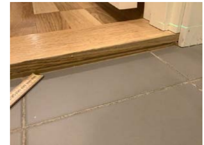
Det er oppkant ved terskel i dør.
