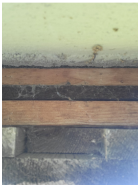
For lite eller ingen lufting under stående kledning.
