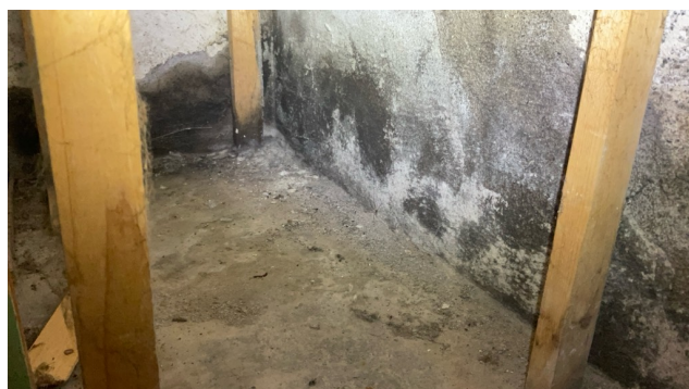
Saltutslag på kjellerveggen.
