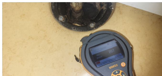
Forhøyede fuktverdier målt ved sluk i gulv.
