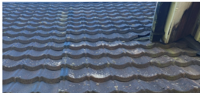
Slitasje på overflate på takplater.
