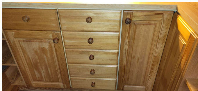
Slitasje på overflater
