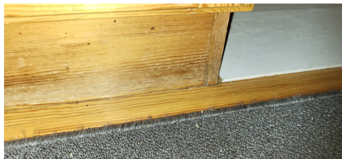
Skade på sokkel.
