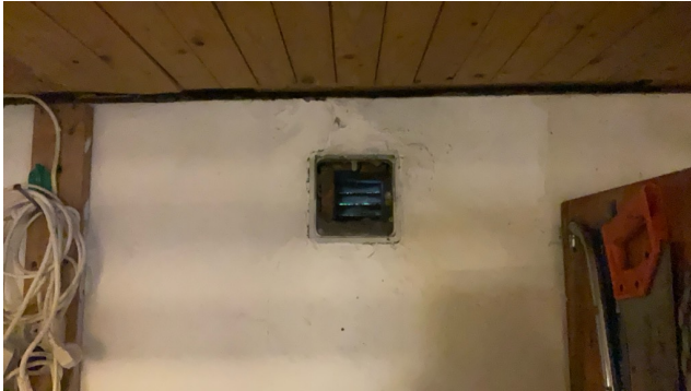
Ventil i vegg.
