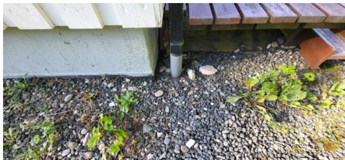
Nedløp tilkoblet overvannsrør.
