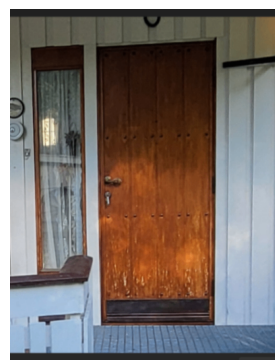
Overflateslitasje på hoveddør.
