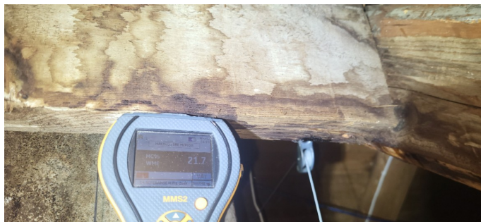
På en plass ble det målt forhøyede fuktverdier.
