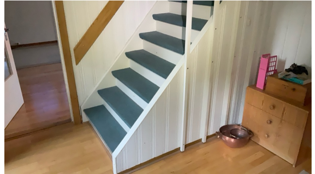
Manglende rekkverk i nedre del av trappa.
