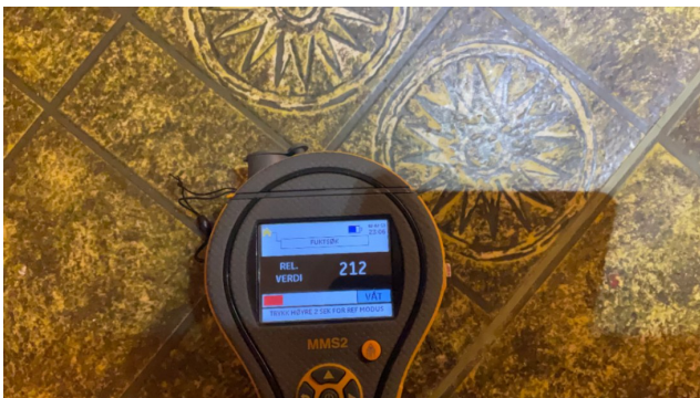
Fuktmåling i gulv med høye fuktverdier.
