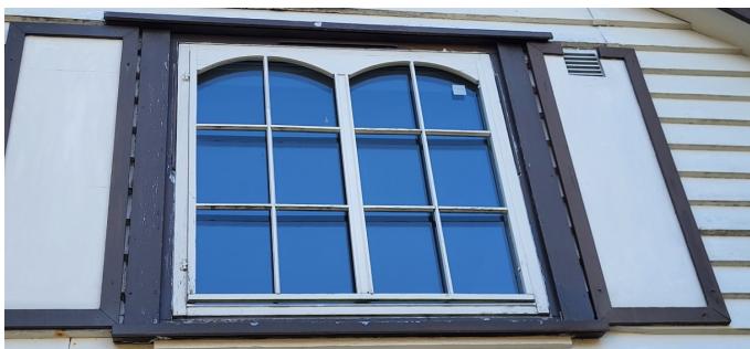
Eldre vindu på loft fra 1978.
