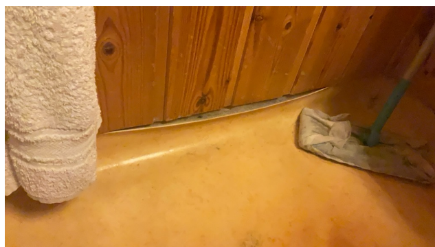
Belegg er løsnet fra vegg.
