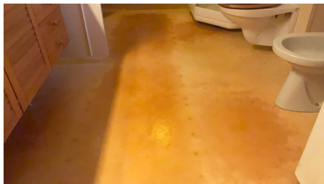
Merker i gulvbelegg.
