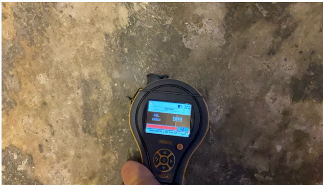
Fuktmåling i gulv med høye fuktverdier.
