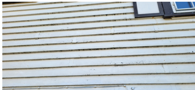
Overflateslitasje på kledning mot vest.
