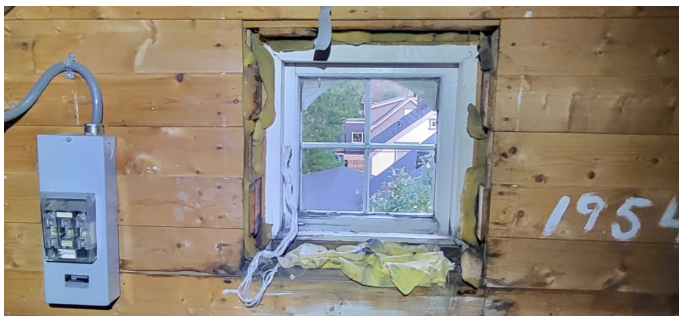
Råteskadet vindu på kaldloft.
