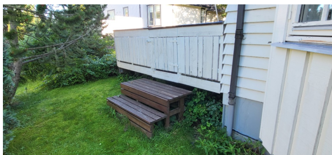
Manglende rekkverk på trapp.
