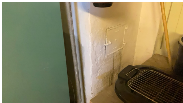
Sotluke i kjeller.
