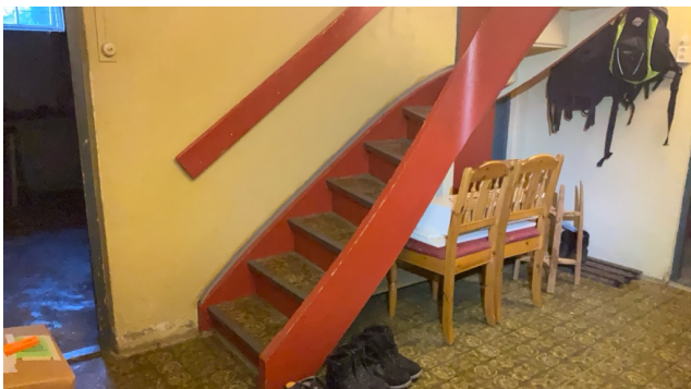
Manglende rekkverk i trappa.
