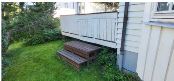
Manglende rekkverk på trapp.
