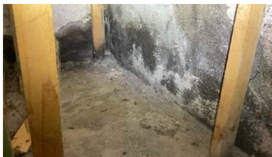
Saltutslag på kjellervegger.
