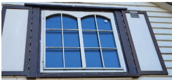
Eldre vindu på loft fra 1978.
