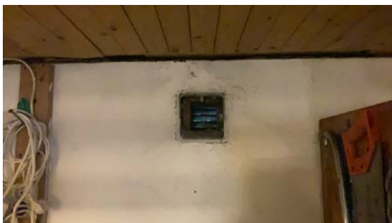
Ventil i vegg.
