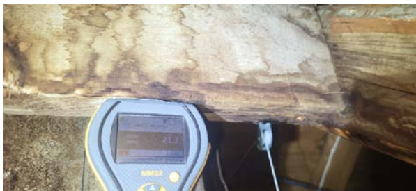
På en plass ble det målt forhøyede fuktverdier.
