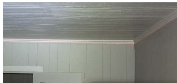
Skjevhet i himling i stue mot øst
