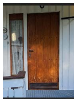
Overflateslitasje på hoveddør.
