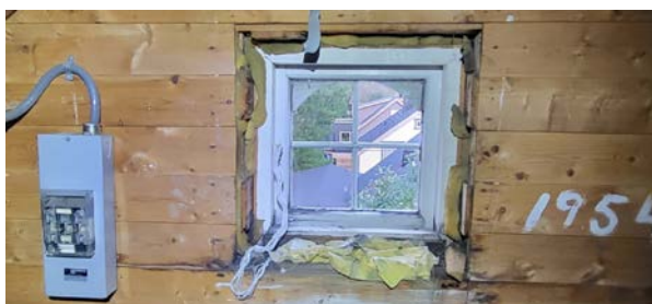
Råteskadet vindu på kaldloft.
