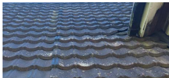
Slitasje på overflate på takplater.
