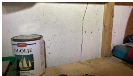
Sprekk i innvendig mur.
