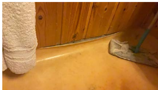
Belegg er løsnet fra vegg.
