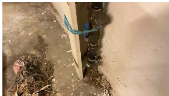
Stoppekrane i kjeller.
