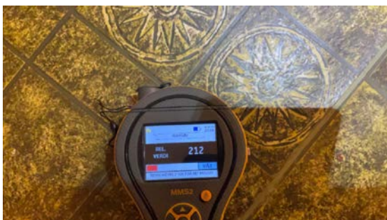
Fuktmåling i gulv med høye fuktverdier.
