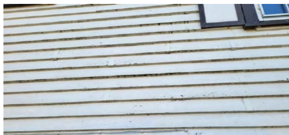
Overflateslitasje på kledning mot vest.
