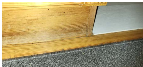
Skade på sokkel.
