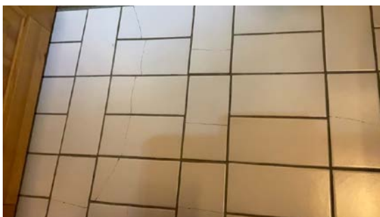
Flisegulv er sprukket.
