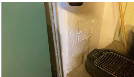
Sotluke i kjeller.
