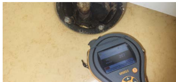
Forhøyede fuktverdier målt ved sluk i gulv.
