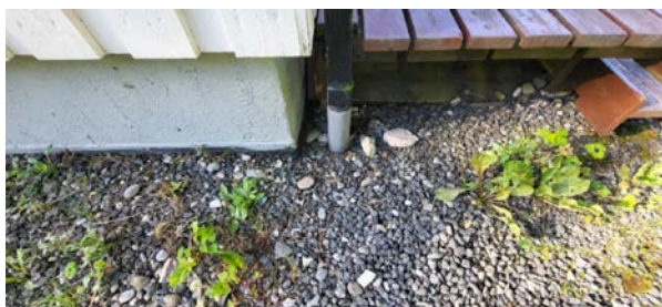
Nedløp tilkoblet overvannsrør.
