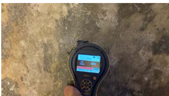
Fuktmåling i gulv med høye fuktverdier.
