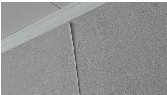
Tapet løsner i skjøt.
