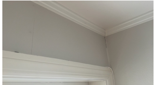
Sprekk i veggjørne.
