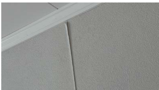
Tapet løsner i skjøt.
