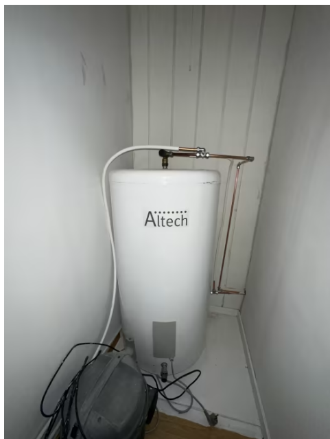
Bereider plassert i bod. Rørstrekk til bereder mangler klammer.
