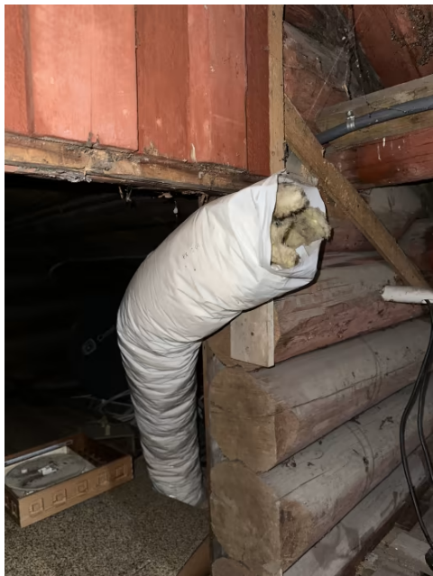
Avtrekk ført til loft. Anbefales ført ut mot fri.
