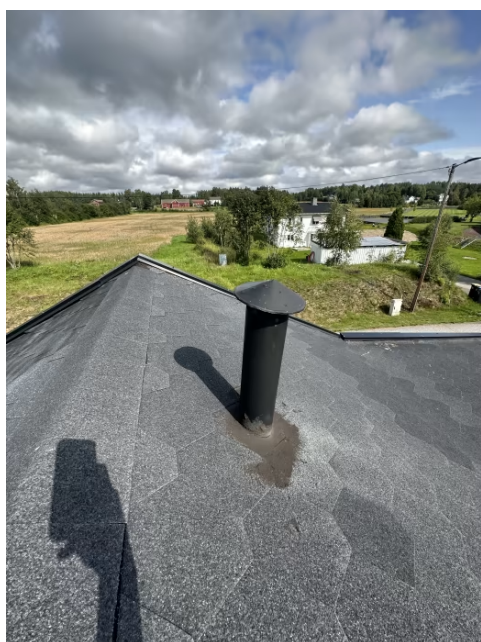
Viser tetting rundt lufting.
