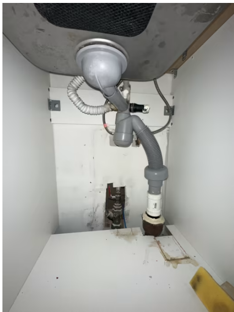
Viser vann- avløpsinstallasjoner under kum.
