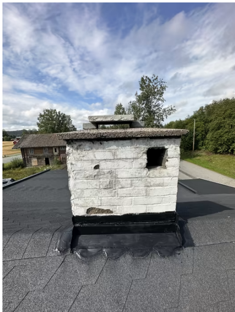
Viser avskalling på pipe. Steiner benyttet som regnskjerm. Pipe for lav i forhold til krav.
