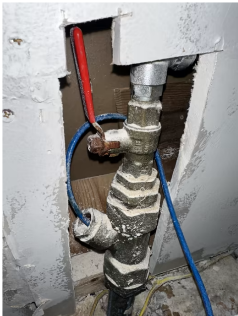
Rust på håndtak til stoppekran. Varmekabel påvist ved vanninntak, ukjent tilstand.
