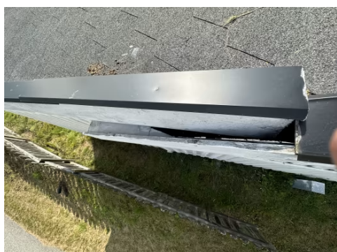
Viser utett skjøl ved tak, beslag/ tetting må påregnes.
