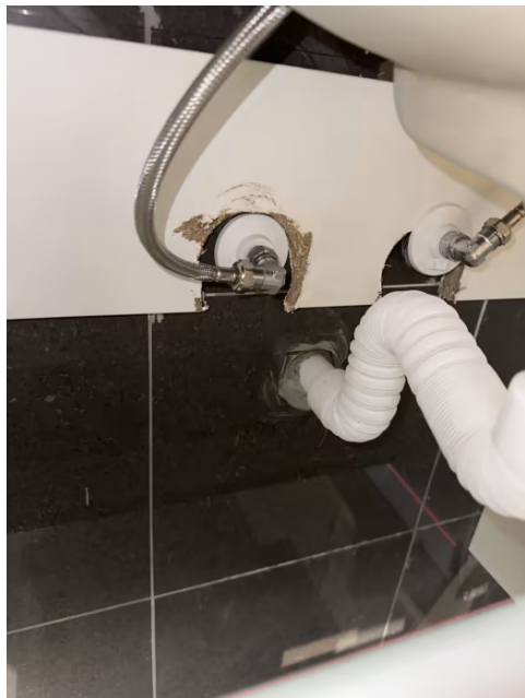
Utett gjennomføring ved avløp.
