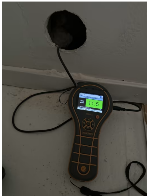
Viser fuktmåling i delevegger bak dusjkabinett.
