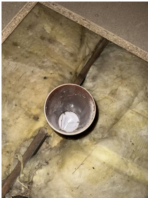
Ventil i tak ført til loft. Anbefales mekanisk vifte ført ut mot fri.
