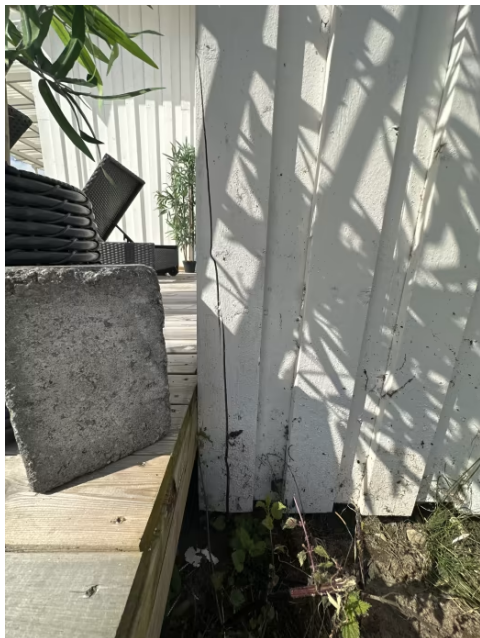
Viser sprekke i bordkledning.
