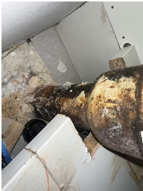
Det er påvist at avløpsrør av jern har rustskader.
