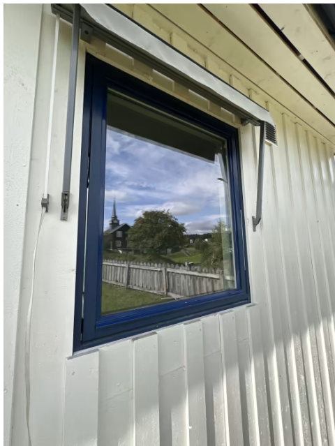
Vannbrett og beslag mangler.
