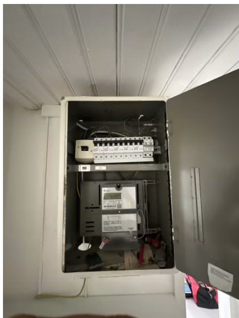
Skap mangler tet nipler rundt kabler.
