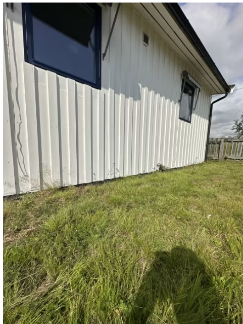
Panel er avsluttet nærmere terreng enn hva som er anbefalt. Fare for fuktopptrekk.
