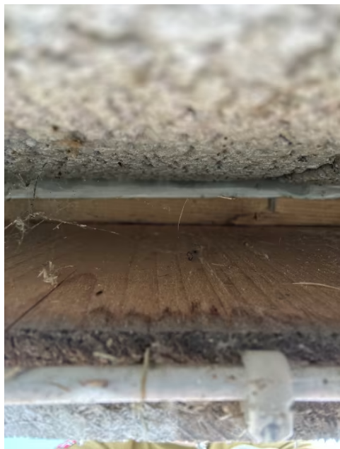
Kledningen er ikke luftet.
