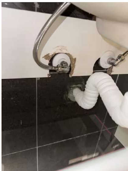
Utett gjennomføring ved avløp.
