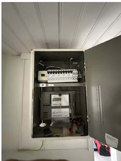
Skap mangler tet nipler rundt kabler.
