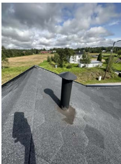
Viser tetting rundt lufting.
