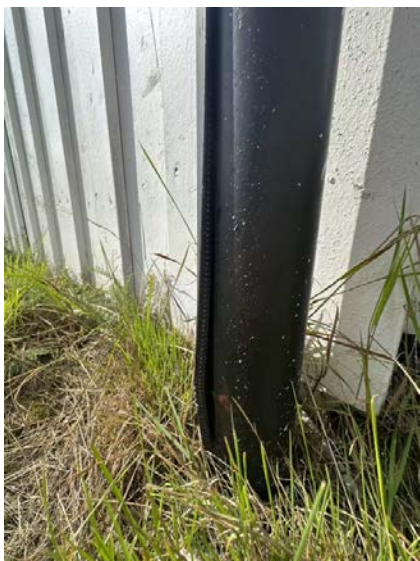
Viser frostsprengte nedløpsrør. Takvann ført bort fra boligen i drensør. Ingen opplysninger om fryste drensør.
