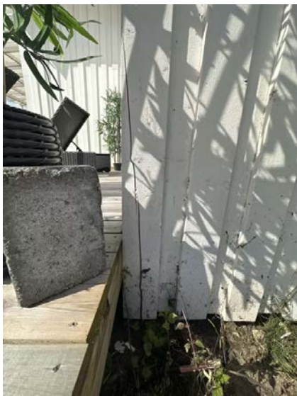
Viser sprekk i bordkledning.
