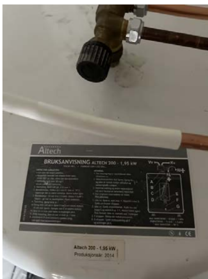
Viser teknisk data på bereder.
