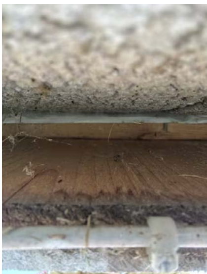
Kledningen er ikke luftet.
