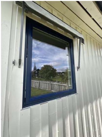
Vannbrett og beslag mangler.
