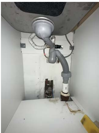
Viser vann- avløpsinstallasjoner under kum.
