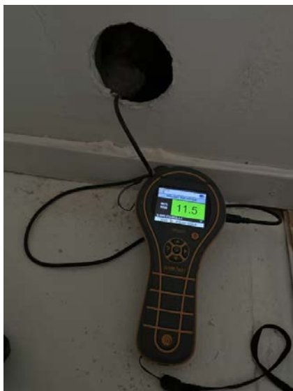
Viser fuktmåling i delevægger bak dusjkabinett.
