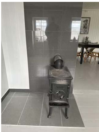
Viser ildsted montert i stue.
