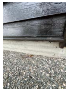
Liten skade i underkant av vannese.
