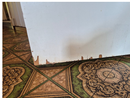
Skade på dørblad til toalettrom.
