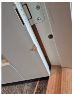
Skade på dørblad til bad i kjeller.
