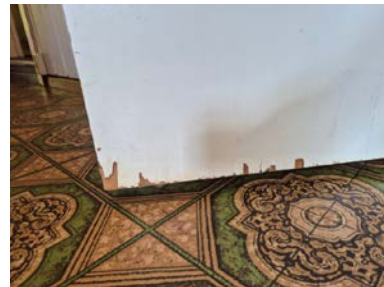
Skade på dørbord til toalettrom.
