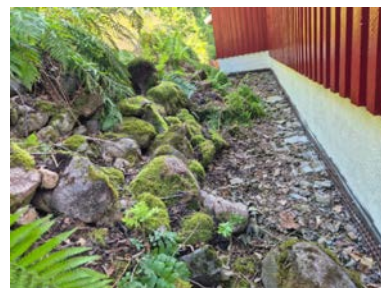
Flatt terreng mot grunnmur.
