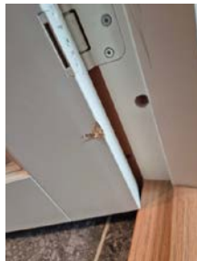
Skade på dørbord til bad i kjeller.
