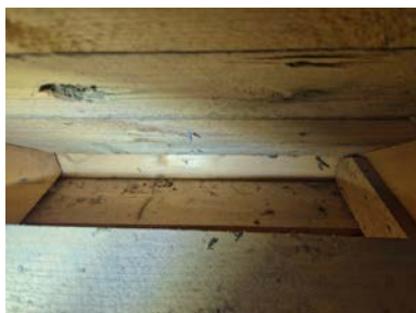
Ingen luft i nedre del av kne loft.
