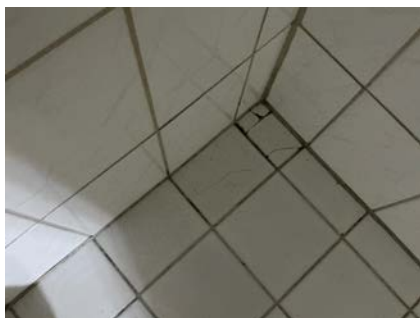
Riss i fliser i våtsonen
