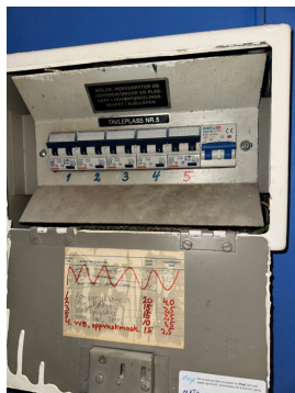
Sikringskap med automatsikringer.
