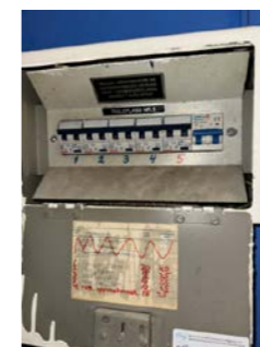
Sikringsskap med automatsikringer.
