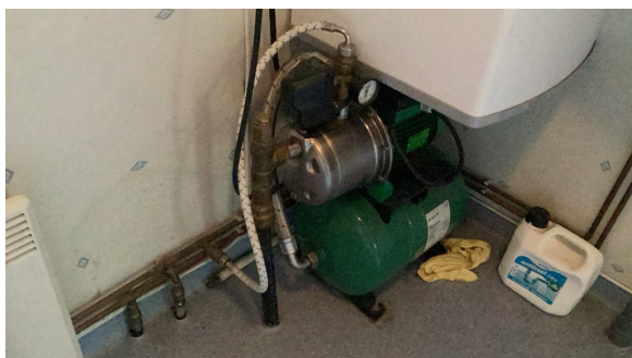
Vanninntak på bad.
