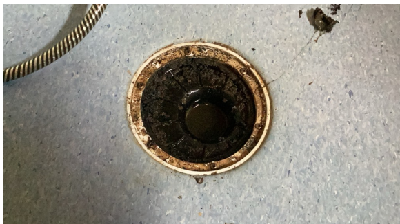
Sluk av plast med klemring.
