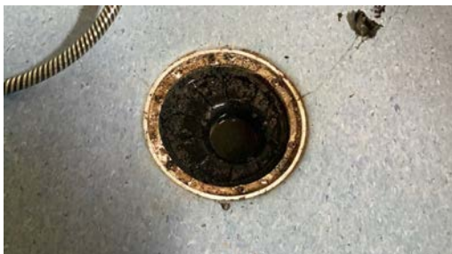
Sluk av plast med klemring.
