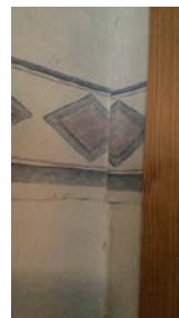
Belegg begynner å løsne i skjøt i hjørne.
