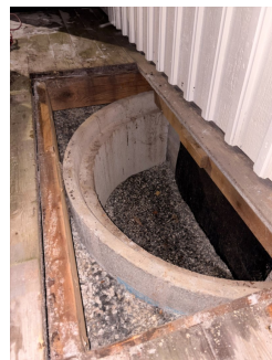
Luke i gulv for adkomst til krypekjeller.
