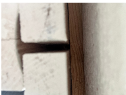
Åpning i kledning der mus kan komme inn
