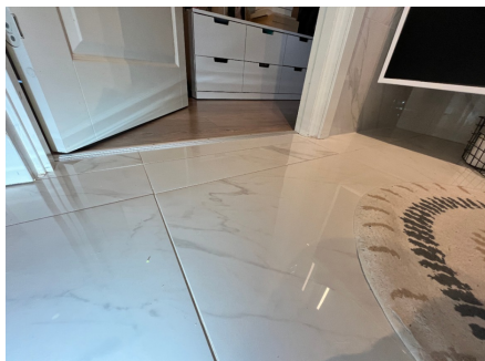
Ikke oppkant under dør
