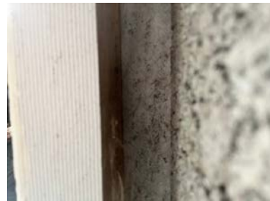
Ikke lufting i nedkant på vegg
