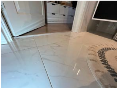
Ikke oppkant under dør
