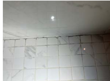
Sprekk i elastisk fuge
