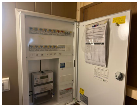
Sikringsskap med kursfortegnelse/dokumentasjon.
