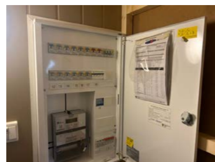
Sikringskap med med kursfortegnelse/dokumentasjon.
