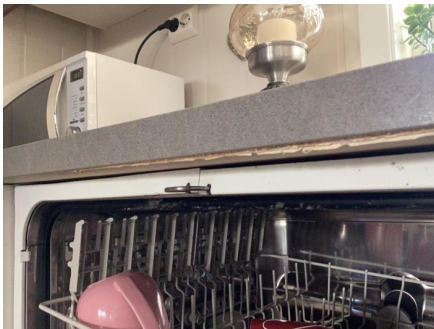
Fuktskade i benkeplate over oppvaskmaskin.
