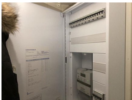
Sikringsskap i gang 1 etg.
