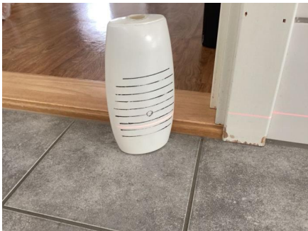
Ca 17 mm høydeforskjell fra topp slukrist til gulv ved terskel.
