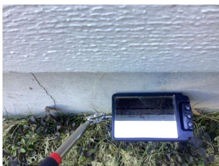
Ingen lufting av panel.
