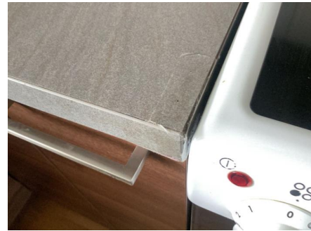
Skade i benkeplate ved komfyr.
