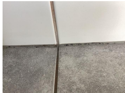
Svertesopp i silicon fug overgang gulv vegg i dusjhjørne.
