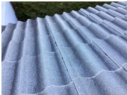
Taktekking med mose.
