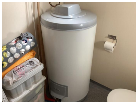
Varmtvannstank på vaskerom.
