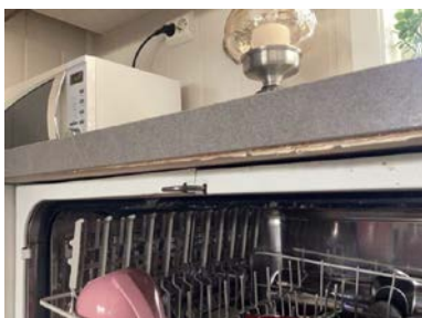
Fuktskade i benkeplate over oppvaskmaskin.
