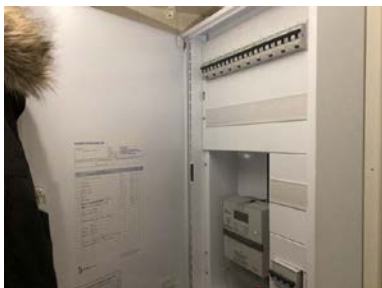
Sikringsskap i gang 1 etg.
