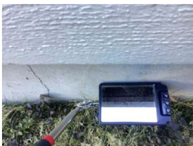
Ingen lufting av panel.
