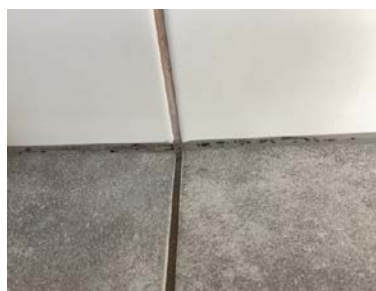
Svertesopp i silicon fug overgang gulv vegg i dusjhjørne.
