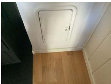
Ingen ubrennbar plate under feieluke.
