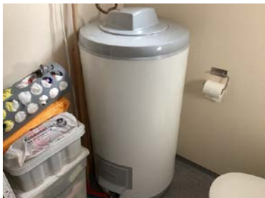
Varmtvannstank på vaskerom.
