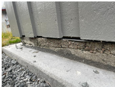
Synlige sprekkdannelser i gammel mur
