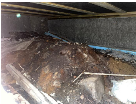
Mangler fuktsperre på grunn/tilbygg
