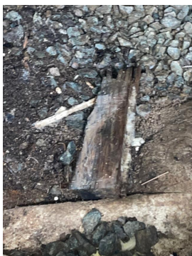
Råteskadet trevirke i krypkjeller
