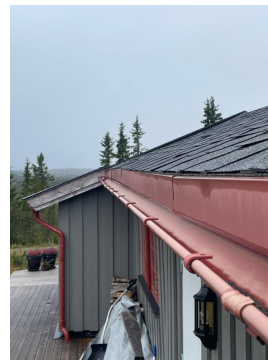
Synlige skeivheter i takkonstruksjonen
