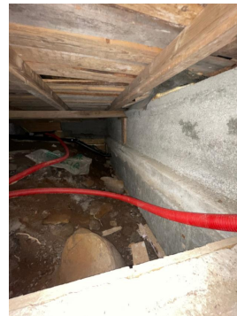
Mangler fuktsperre på grunn/hytte
