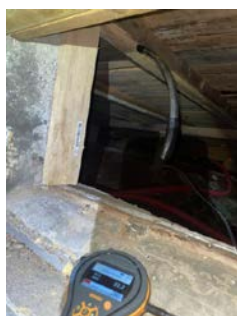
Det måles høye fuktverdier med ytterligere skadepotensiale for sopp/råte.
