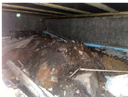
Mangler fuktsperre på grunn/tilbygg
