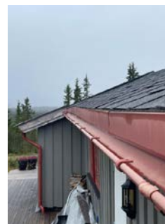
Synlige skeivheter i takkonstruksjonen
