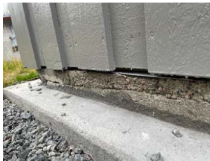
Synlige sprekkdannelse i gammel mur
