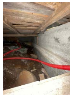
Mangler fuktsperre på grunn/hytte
