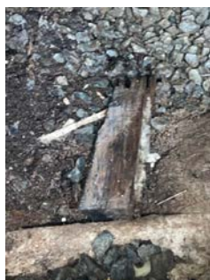
Råteskadet trevirke i krypkjeller
