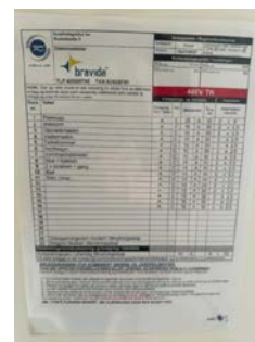
Kursoversikt i sikringskap utarbeidet av Bravida
