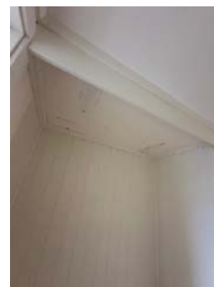
Ventilasjonsanlegg plassert i entre.
