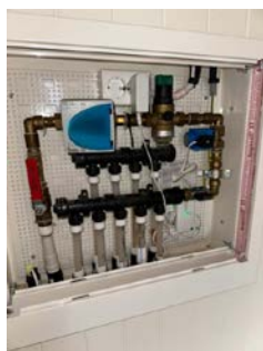
Samleskap med rørkurser og stoppekraner
