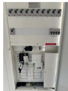
Sikringskap med automatsikringer.
