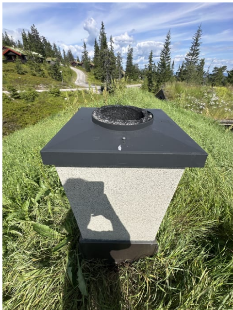
Viser pipe over tak. Regnskjerm mangler.
