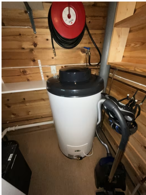
Viser bereder plassert i bod.
