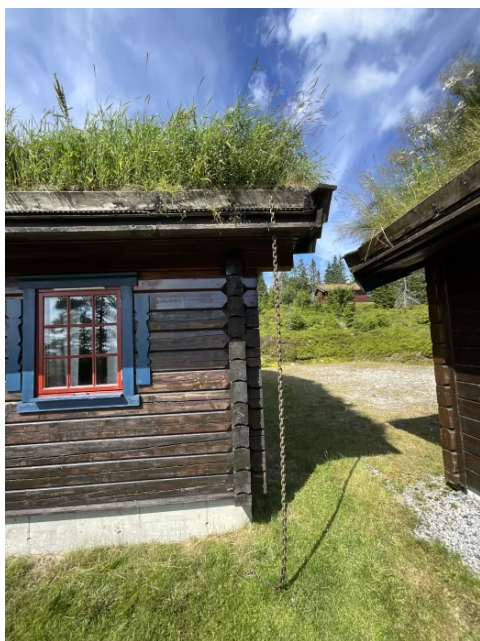
Viser tretaskrenner og nedløp med kjetting.
