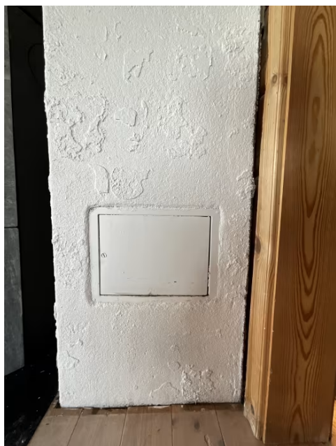
Viser sotluke. Ildfast plate under sotluke mangler.
