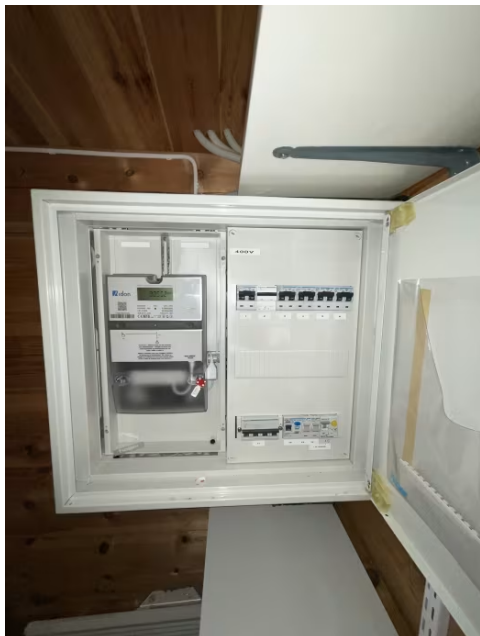
Viser sikringskap plassert i bod.
