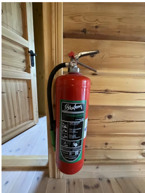
Viser vegghengt brannslukningsapparat.
