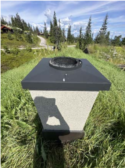
Viser pipe over tak. Regnskjerm mangler.
