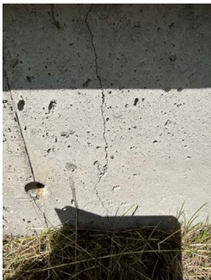
Det er registrert skråriss som er symptom på setninger.
