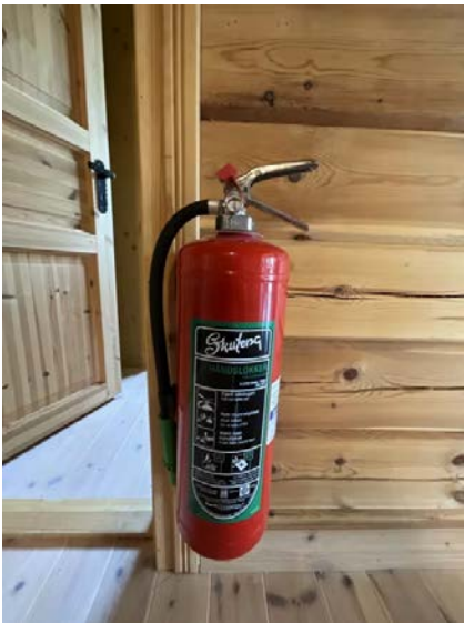
Viser vegghengt brannslukningsapparat.
