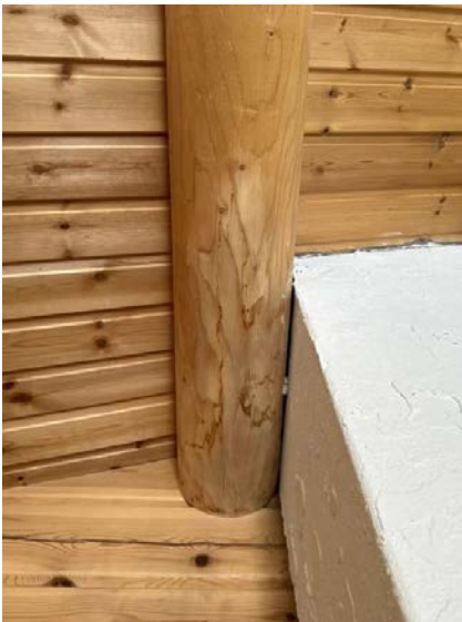
Det registreres fuktskjolder i tak rundt pipe.
