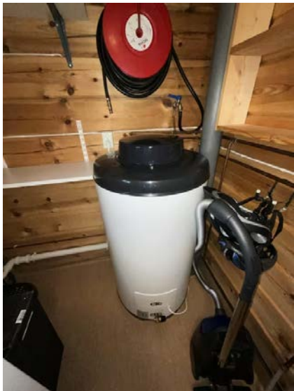
Viser bereder plassert i bod.
