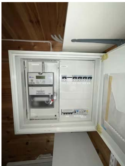
Viser sikringsskap plassert i bod.
