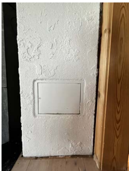
Viser sotluke. Ildfast plate under sotluke mangler.
