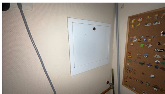
Skap til rør i rør system.
