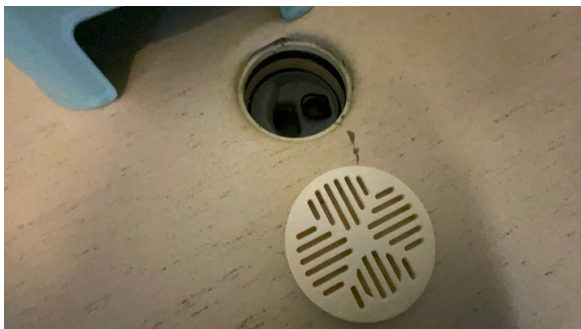
Sluk i gulv.
