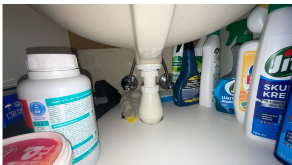
Del av rør til avløp.
