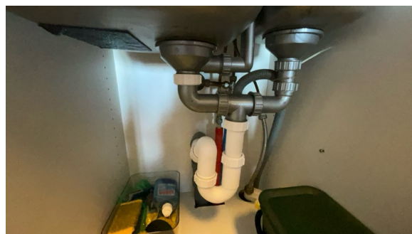
Del av rør til avløp.
