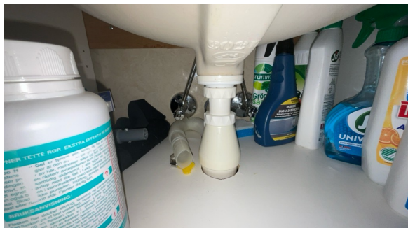
Del av rør til vann.
