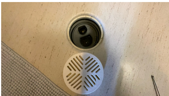
Sluk i gulv.
