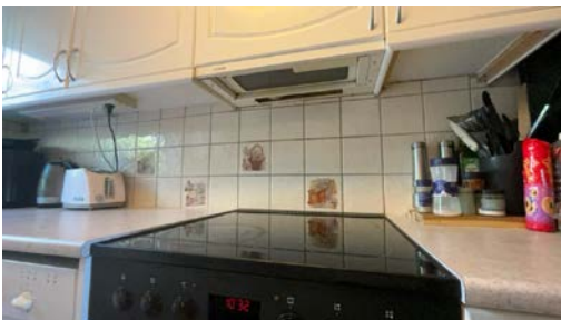
Montert avtrekk over komfyr.
