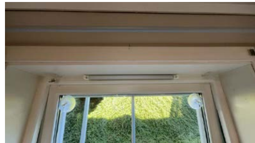
Eksempel på montert ventil i vindu.
