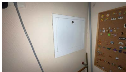
Skap til rør i rør system.
