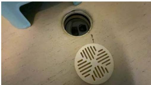
Sluk i gulv.
