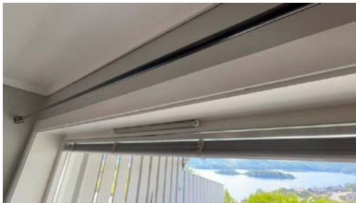
Eksempel på montert ventil i vindu.
